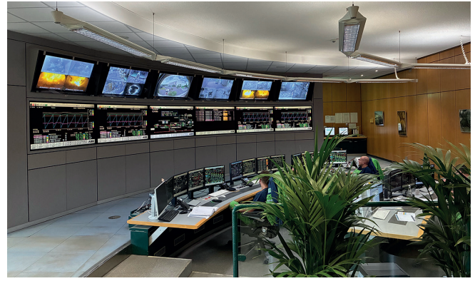
Abb. 2: Blick in die Schaltwarte der Restmüllverbrennungsanlage (© Klaus Maßmeyer).
