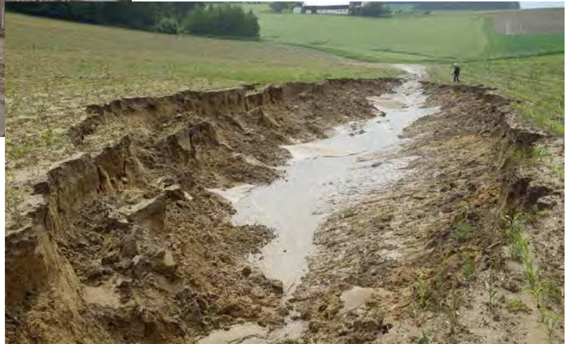
Auskolkung als Folge des Starkregenereignisses, (Foto vom 03.06.2016)
