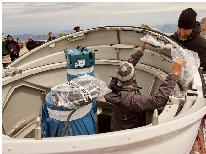
Abb. 1: Höchstgelegene Baustelle Deutschlands: Das Observatorium des KIT auf der Zugspitze erhält eine neue Beobachtungskuppel (© Amadeus Bramsieve, KIT).
