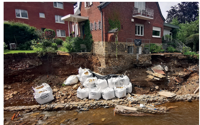
Abb: Begutachtete Gebäudeschäden nach der Flutkatastrophe (© DLR (CC BY-NC-ND 3.0)).
