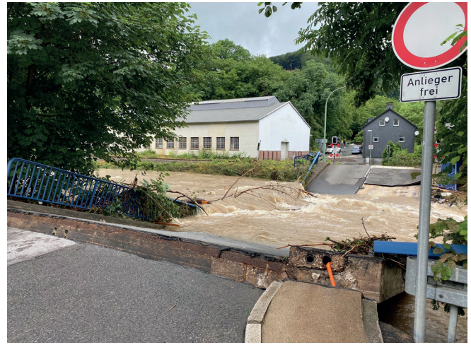
Abb. 5: Zerstörte Brücke am Ortsausgang Priorei infolge des massiven Aufstaus von Treibgut am Morgen des 15.07.21 (© Bastian Rissling).
